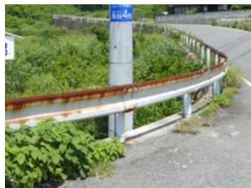
劣化が進んだガードレール
