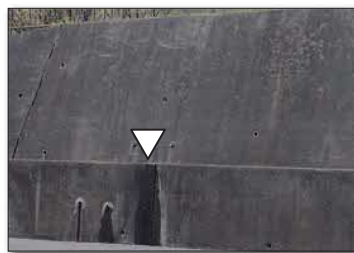
地下水の流出
