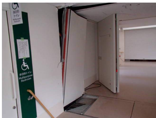
熊本地震で被害を受けた耐震棟と免振棟との接続部分
