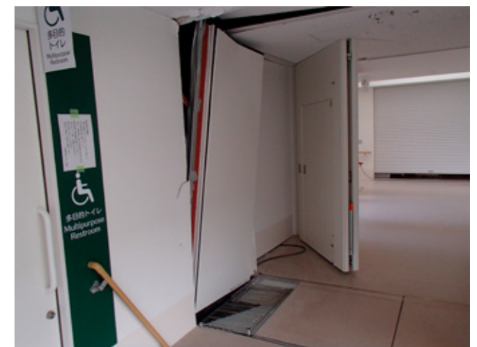
熊本地震で被害を受けた耐震棟と免振棟との接続部分
