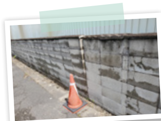
◀危険なブロック塀
